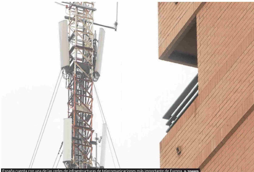
España cuenta con una de las redes de infraestructuras de telecomunicaciones más importante de Europa. D. TORRES
